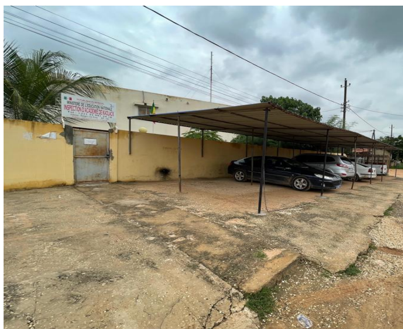
Figure 4 : Vue de la dalle impactée de l'équipement collectif EC0001
